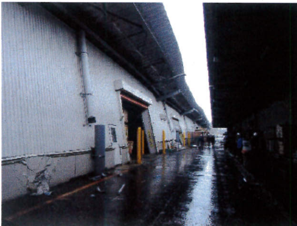
積雪加重に耐えられず建屋側面が大きく傾斜
