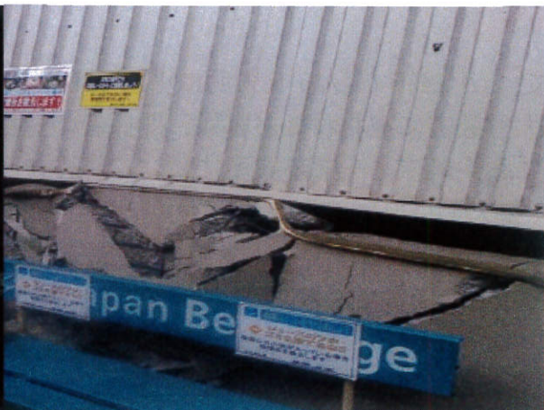
基礎部分から大きく破損し崩壊
