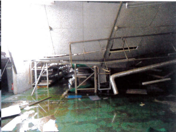
生産ライン上部屋根の崩落
